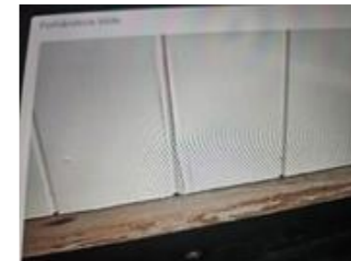
Nedre del av dørbladet på verandadøren er slitt
