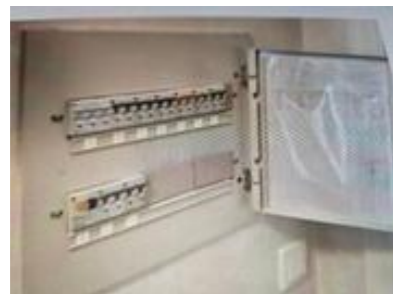
Sikringskap med automatsikringer og kursfortegnelse
