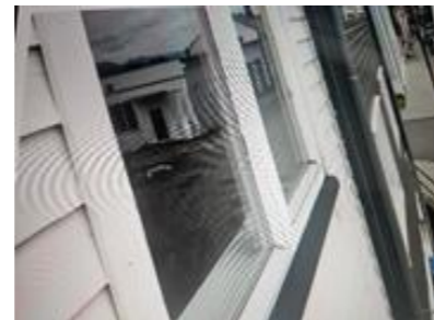
Vinduene mot sør er værslitte
