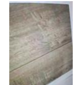
En skjøt i laminatgulvet er ikke helt tett
