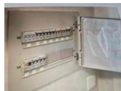
Sikringskap med automatsikringer og kursfortegnelse
