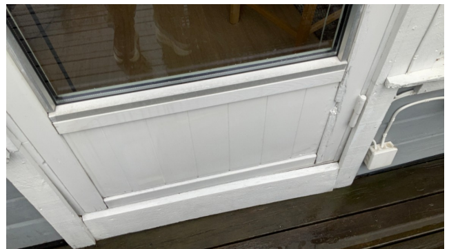
Råteskader på brystning
