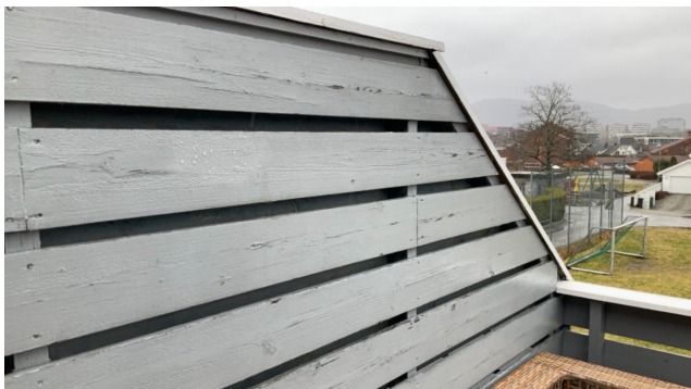
Malingsavflassing på enkelte overflater, her levegg.
