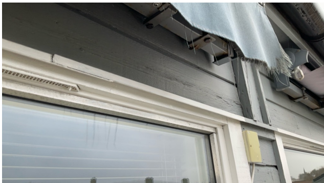
Deler av bordkledning med råteskader.
