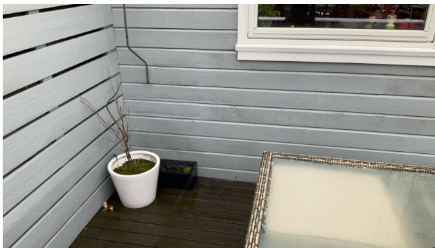
Deler av bordkledning med råteskader
