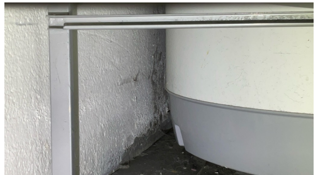
Salt/kalkutslag på deler av muryttervegg.
