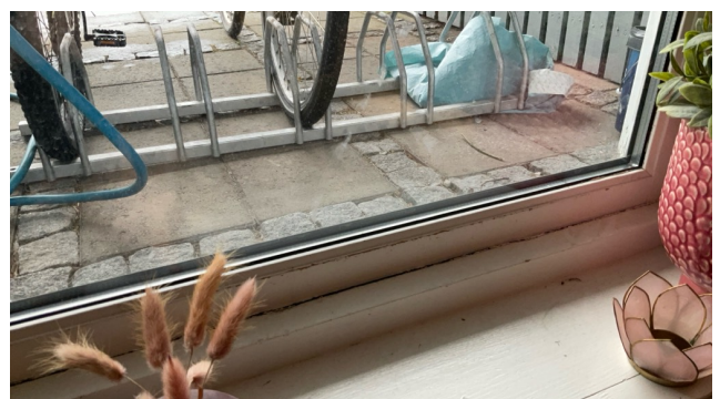
Slitasjemerker/avflassing, her på innside vindu i soverom kjeller
