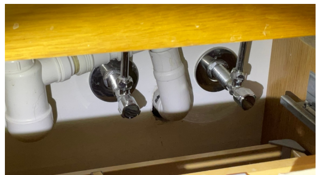
Ikke fuktrettet rørgjennomføring i vegg under vask.
