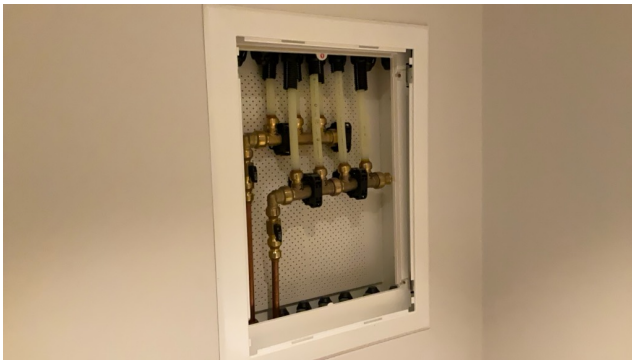
Vannfordelerskap til bad i 1 etg.
