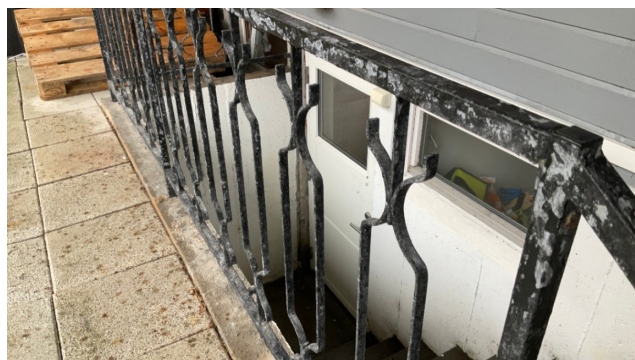
Avflassing på rekkverk kjellertrapp.
