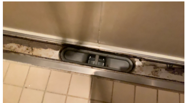
Sluk i gulv.
