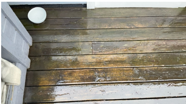
Vær/bruksslitasjer på terrassebord.
