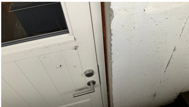
Kjellerytterdør ikke belistet på utside.
