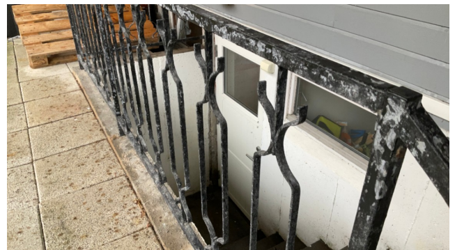
Avflassing på rekkverk kjellertrapp.
