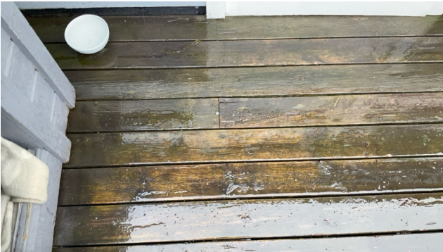
Vær/bruksslitasjer på terrassebord.
