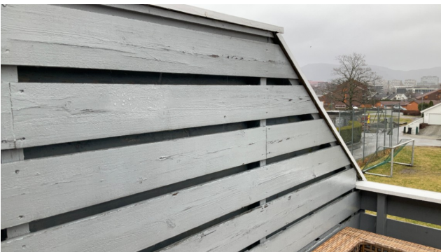
Malingsavflassing på enkelte overflater, her levegg.
