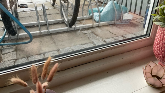
Slitasjemerker/avflassing, her på innside vindu i soverom kjeller
