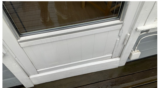
Råteskader på brystning
