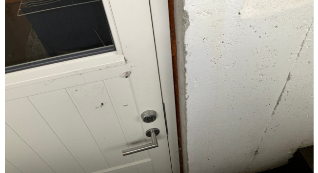
Kjellerytterdør ikke belistet på utside.
