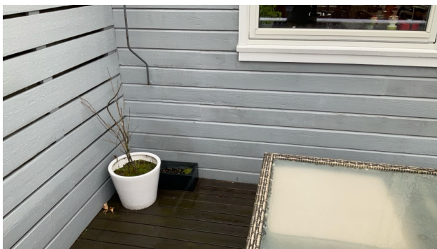
Deler av bordkledning med råteskader
