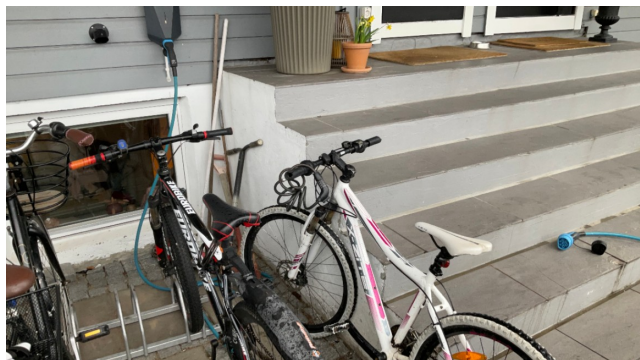
Utendig trapp uten rekkverk/fallsikring
