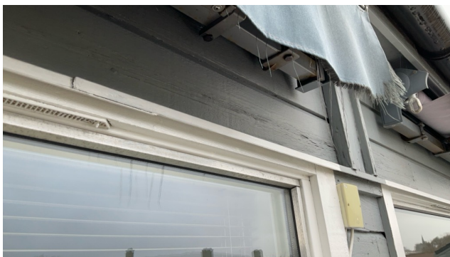
Deler av bordkledning med råteskader.
