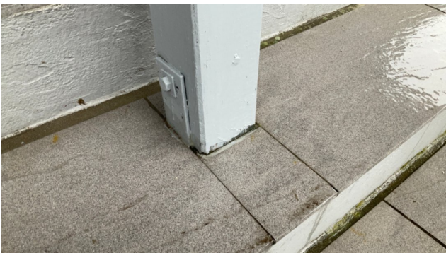
Søyle under balkong kommer for nær/i underlaget.
