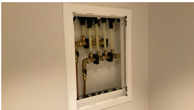
Vannfordelerskap til bad i 1 etg.
