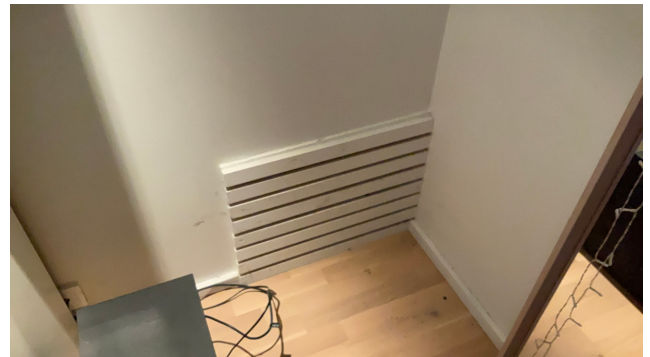
Luke med stengekran på vann.
