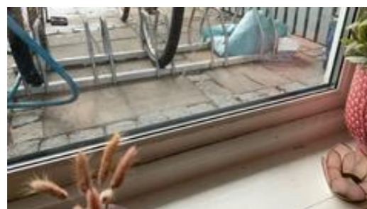
Slitasjemerke/avflassing, her på innside vindu i soverom kjeller
