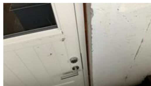
Kjellerytterdør ikke belistet på utside.
