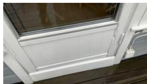
Råteskader på brystning
