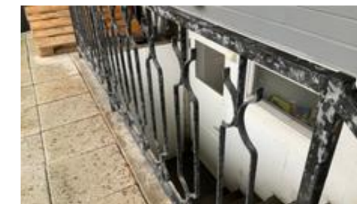
Avflassing på rekkverk kjellertrapp.
