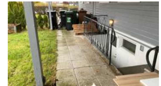
Fall på bakside med lite eller ingen fall fra mur.
