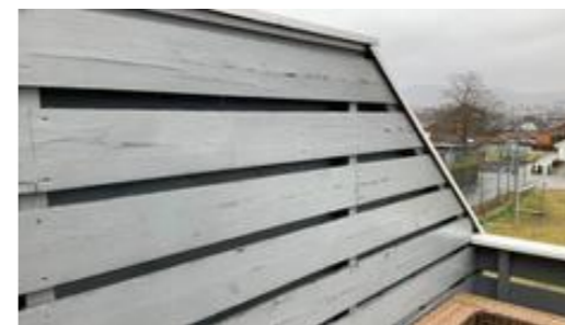
Malingsavflassing på enkelte overflater, her levegg.
