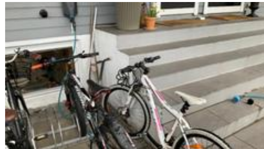
Utvendig trapp uten rekkverk/fallsikring
