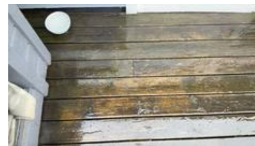
Vær/bruksslitasjer på terrassebord.
