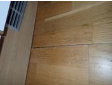
Skade i parkett.
