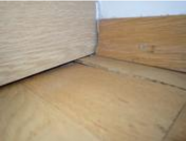
Skade i parkett.
