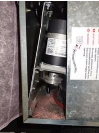
Defekt reim og innfesting i ventilasjonsaggregat.
