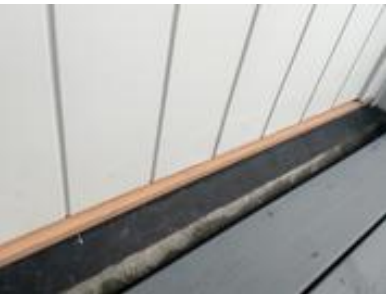
Nedre kant av dørbladet er preget av fukt
