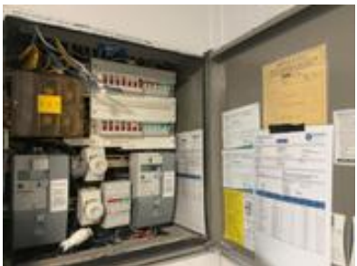
Sikringsskap med automatsikringer og kursfortegnelse
