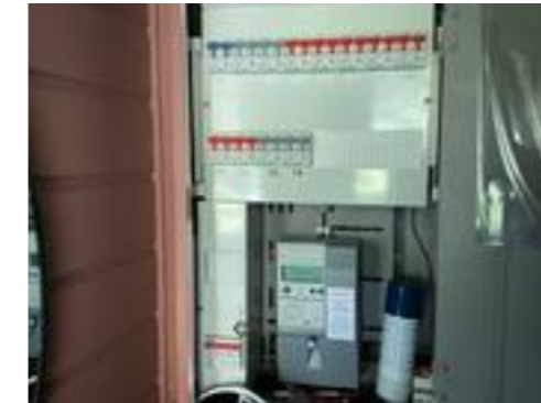
Bilde av sikringskap
