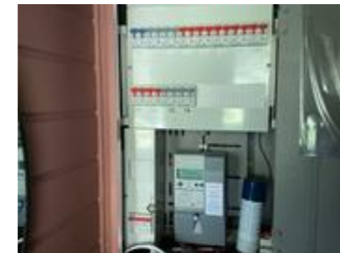
Bilde av sikringskap
