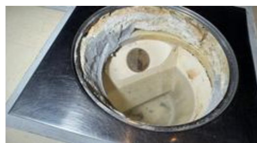
Mer enn halvparten av forventet brukstid er passert på slukløsningen.
