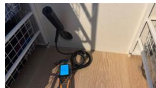
Måleresultatet viser LO, dvs. ikke målbar fukt. 6 vekt% er laveste verdi instrumentet kan måle. Det vil si at hulrom i skillevegg og treverk i kontakt med gulv er helt tørt.
