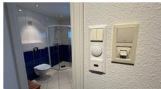
Varme i gulv er panel med trinnbryter. Panel til venstre er for varme i gulv utenfor bad.
