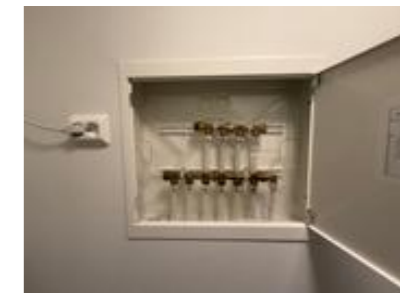
Rør i rør sentral på vaskerom.
