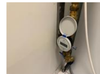
Vannmåler på vaskerom.
