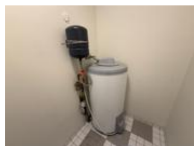
Varmtvannsbereider på vaskerom.
