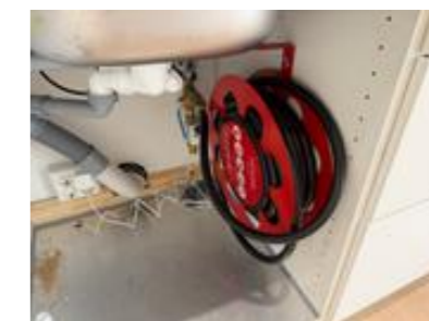
Brannslange i skap under vask på kjøkken.
