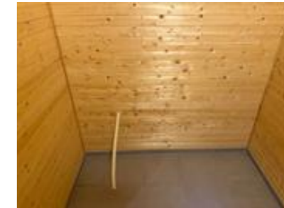
Ikke montert oven i badstue.
