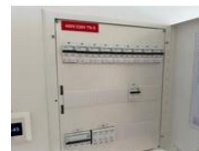
Sikringssskap i stue.
