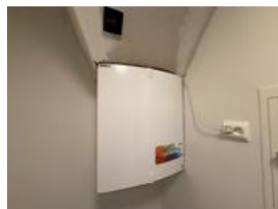
Balansert ventilasjonsanlegg plassert på vaskerom.
