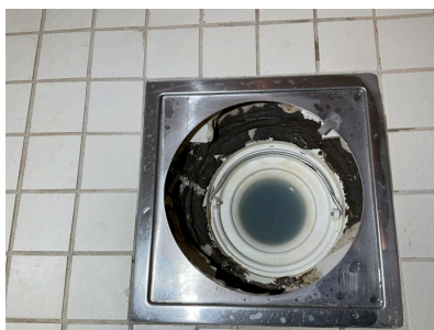
Sluk i dusjsone.
