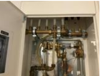
Fordelingskap rør i rør.
