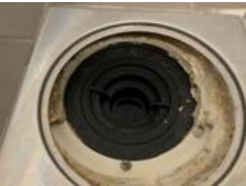
Sluk med synlig membran under klemring.
