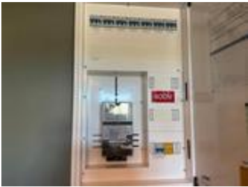
Sikringsskap med automatsikringer.
