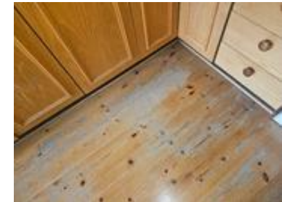
Kjøkkengulvet er slitt
