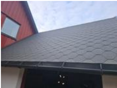
Det er ikke snøfangere langs takfoten
