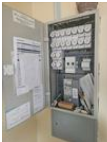
Sikringsskap med skrusikringer og kursfortegnelse
