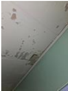
Fuktskadet himling (vaskerom)
