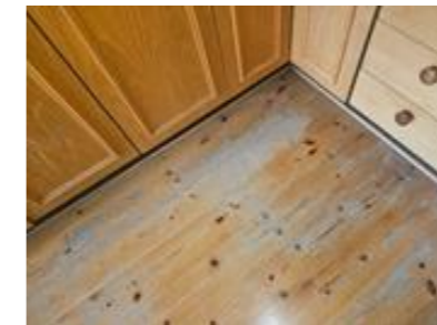
Kjøkkengulvet er slitt
