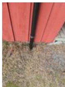
Taknedløp er ført ned i terrenget, usikkert hvor det evt ledes videre
