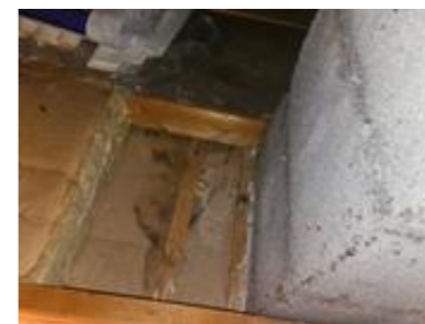
Spor etter lekkasje ved pipen
