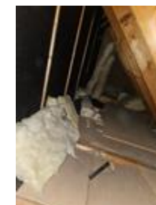
Det har vært en lekkasje ved de isolerte kanalene lengst inne i raftekottet
