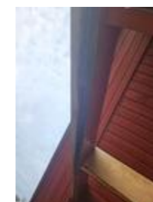
En råteskadd bjelke over verandaen foran loftet
