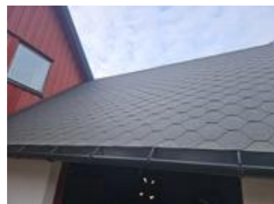
Det er ikke snøfangere langs takfoten
