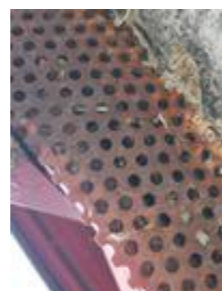
Beslagene i underkant av bordkledningen har begynnende rustdannelse
