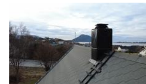
Pipetrek av metall. Fast montert takstige
