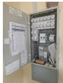
Sikringskap med skrusikringer og kursfortegnelse
