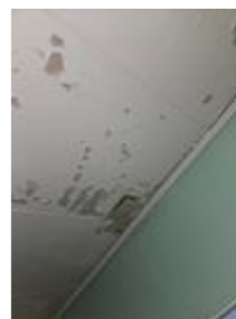
Fuktskadet himling (vaskerom)
