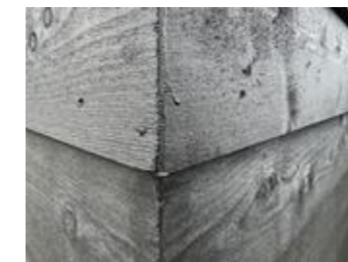
Fagmessige utførelser i ytre hjørner av kledning.
