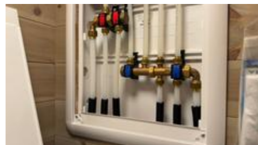
Rør i rørskap befinner seg i kott over bereder.
