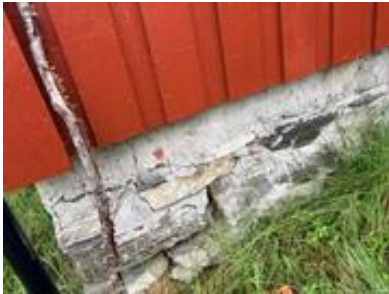
Eksempel på riss/sprekk i grunnmur.
