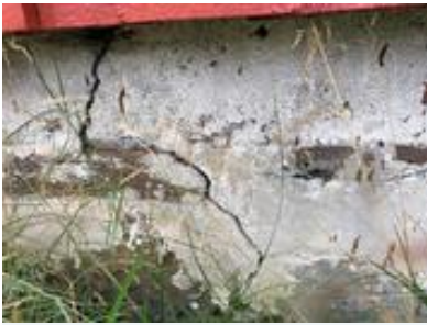
Eksempel på riss/sprekk i grunnmur.
