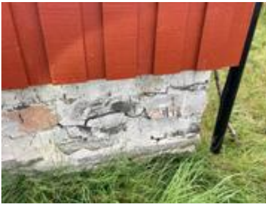
Eksempel på riss/sprekk i grunnmur.
