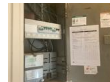
Sikringsskapet i trapperomme
