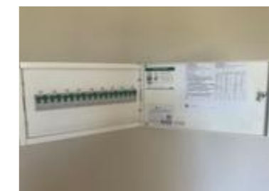
Sikringsskapet på soverommet
