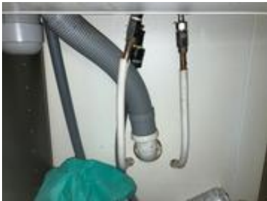
Røropplegg i skap under vask
