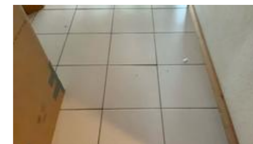
Kanting/ugjevne overflater mellom fliser på gulv.
