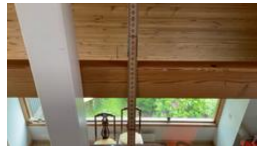
Rekkverk på loft/hems lavere enn 90 cm.
