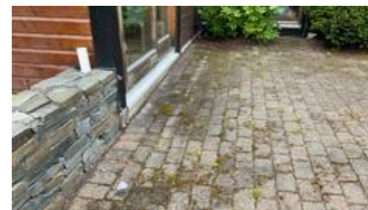
Terreng som faller inn mot mur.
