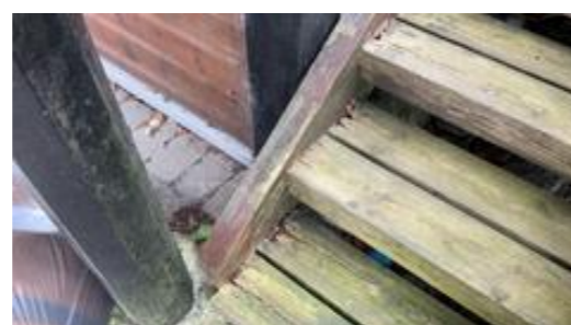
Råteskader på flere trinn i trapp.
