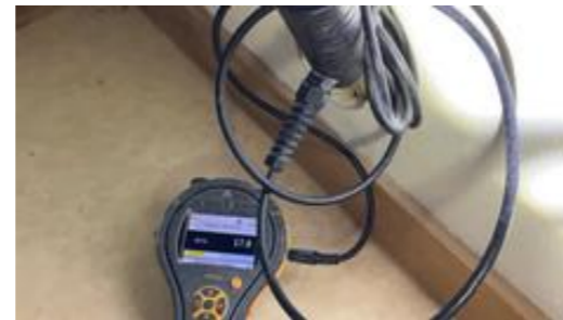
Fuktsøkt i påført yttervegg i underetasje i gult/risikosone.
