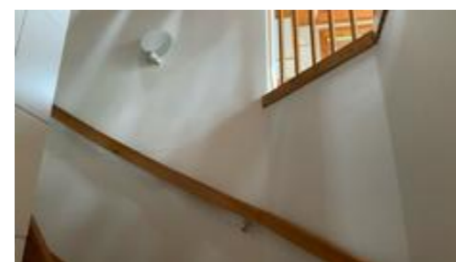
Krymp/ugjevnheter på vegger, her i trapp.
