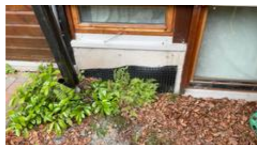
Synlig platonplast på mur som fuktsikring, ikke brukt platonlist på toppen.
