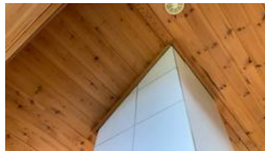
Mindre fuktmerker i panel omkring pipe ved takjennomføringen
