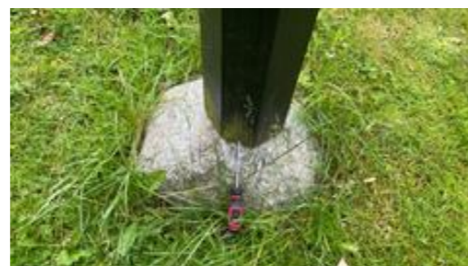
Søylor står for nær underlaget/fundament, trekker opp fukt og får svekkelser.
