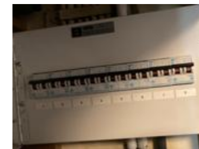
El-tavle i 1. etasje
