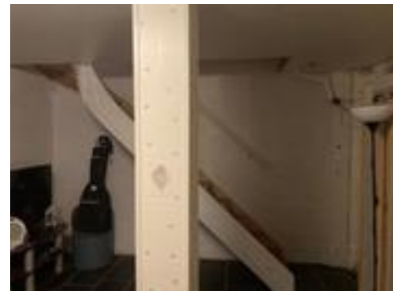
Mangler rekkverk, trapp til kjeller
