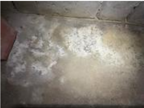
Saltutslag i gulv.
