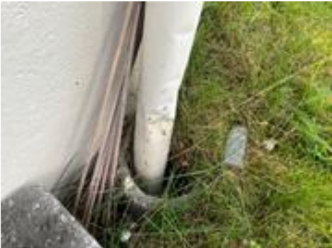
Noen mindre bulker i nedløp.
