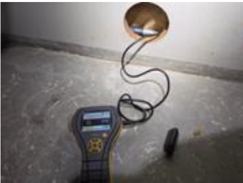
Fuktmåling mot bad i underetasjen.
