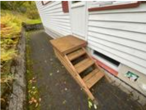
Trappen mangler rekkverk.
