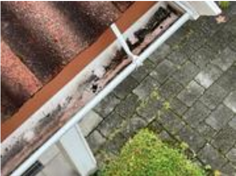
Renne ved takoverbygg har kun små hull for å drenere ut vanne.
