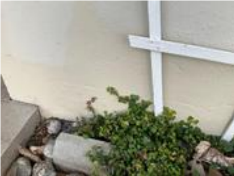
Det er tegn til en sprekk som et tettet.
