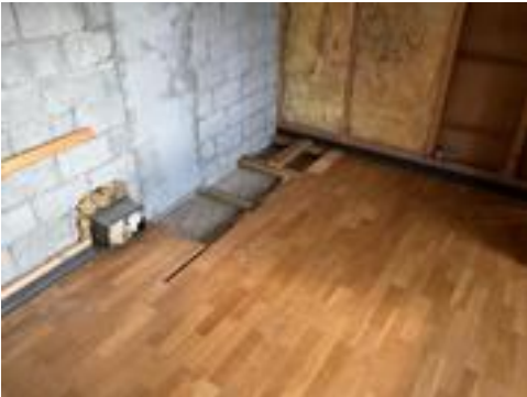
Gulvet er ikke ferdigstilt.
