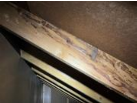
Fuktskjolder i taksperre.
