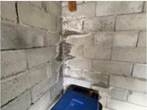
Det er observert saltutslag i garasjen.
