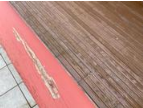
Værslitt terrasse og rekkverk.
