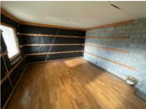
Veggene i rommet er for det meste demontert og ikke bygget opp igjen.
