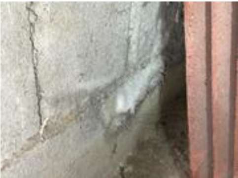
Saltutslag i vegg.
