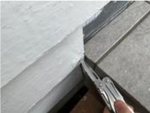
Råteskade ved veranda.
