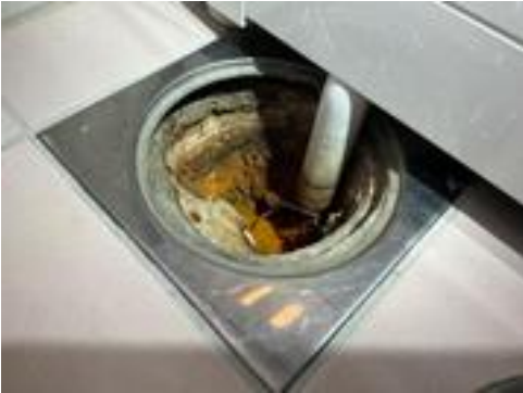
Eldre støpejernssluk og det er ikke observert tettesjikt.
