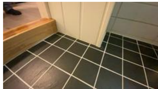
Trepaneler i døråpning står helt ned på gulvfliser.
