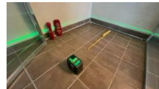
Det er ikke etablert tilstrekkelig fall på gulv mot sluk i dusjnisse, og fall er ikke helt iht. de preaksepterte ytelser knyttet til TEK17.
