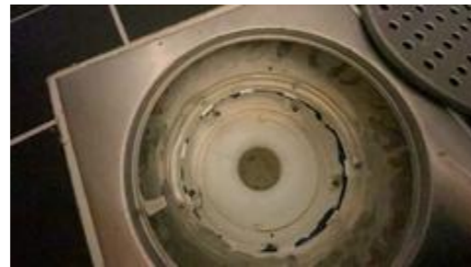
Sluk i gulv.
