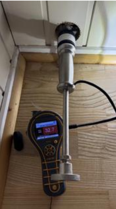
Eksempelbilde av fuktmåling godt over faregrensen for utvikling av sopp/ råteskader.
