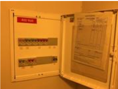
Sikringsskap med automatsikringer og kursfortegnelse
