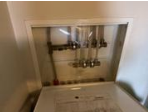
Fordelingsskap for tappevann, med stoppekran
