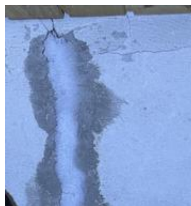
Eksempelbilde av riss/ sprekker på bod i sokkel.
