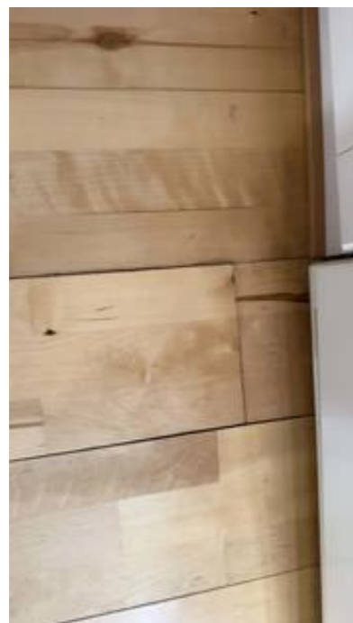
Eksempelbilde av fuktskadet parkett foran kjøleskap.
