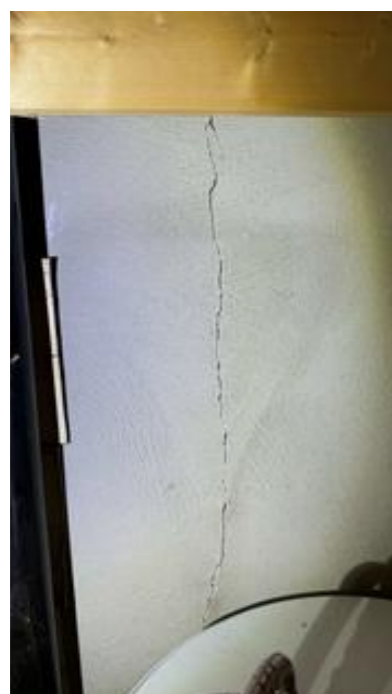
Eksempelbilde av sprekk bak bereder på bad i sokkel.
