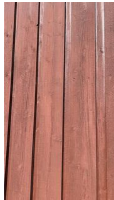
Eksempelbilde av slitt kledning.
