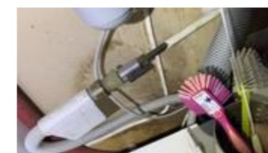
Eksempelbilde av fuktmerker/ svertesopp i vegg under skyllekum.
