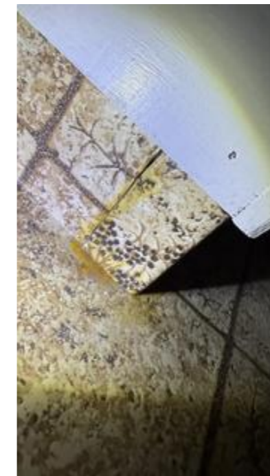
Eksempelbilde av ikke tilfredsstillende tettesjikt/ utette overgang.
