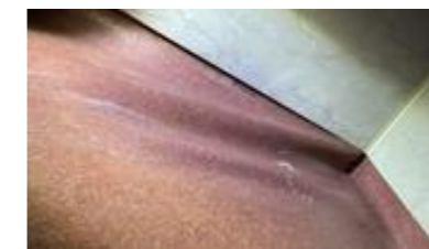
Eksempelbilde av løst belegg.
