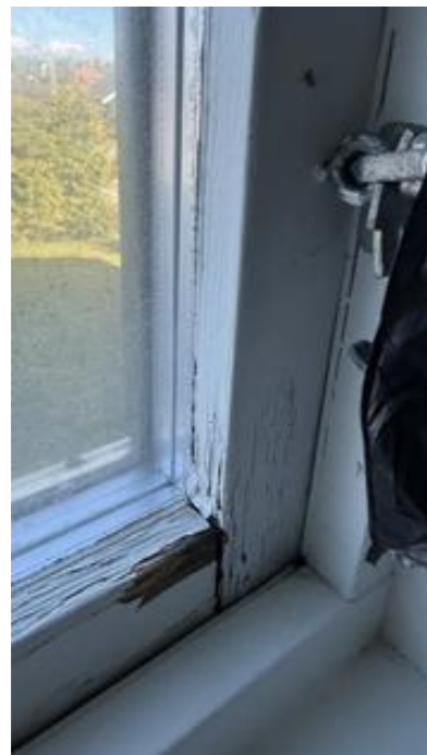
Eksempelbilde av innvendig malingsavlass/ fuktmerker.
