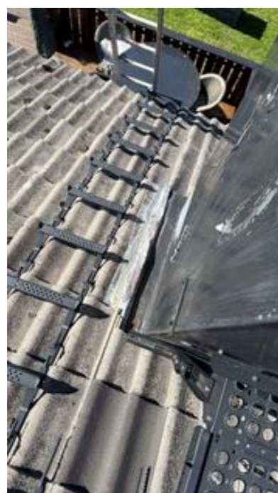
Eksempelbilde av slitasjegrad/ rustdannelse og malingsavflass til pipebeslag.
