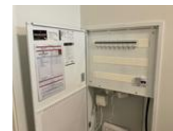
Oversikt over sikringskapet.
