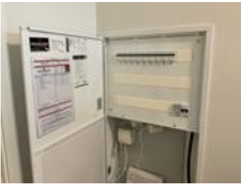
Oversikt bilde av sikringsskap.
