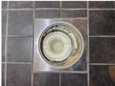
Sluk i dusjsone.
