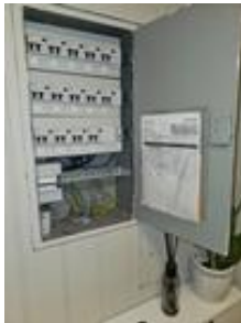
Sikringskap med automatsikringer og kursfortegnelse
