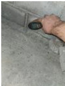
Utslag på fuktindikator langs nedre kant av grunnmuren, trolig kapillærsug fra grunnen
