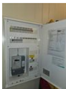
Sikringskap med automatsikringer og kursfortegnelse
