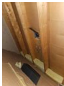
Fuktmerker på undertaket ved luftehatt
