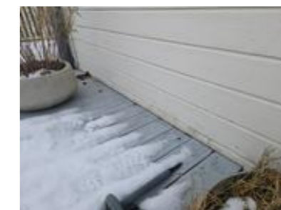
Det er ikke montert beslag i overgangen mellom veranda / terrassedekke og tilstøtende del av ytterveggen
