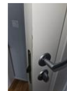
Folien på dørbladet har begynt å løsne
