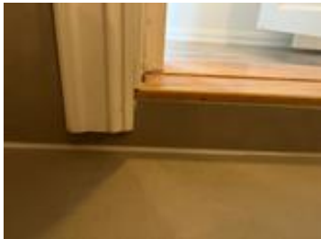
Overgang ved terskel på bad i første etasje.
