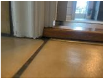
Overgang ved terskel på vaskerom. Ingen synlig membran.
