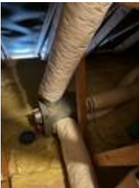
Avtrekksvifta er plassert på kaldt loft.
