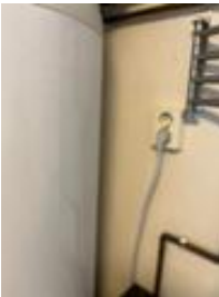
Varmtvannsberederen er tilkoblet med stikkontakt.
