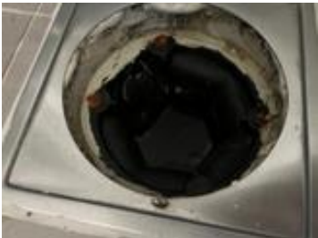
Sluket på baderommet i første etasje.
