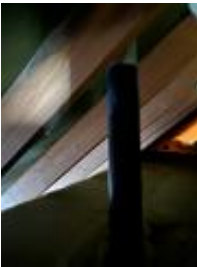
Gjennomføring i undertak. Kjøkkenventilator.
