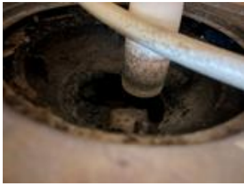
Sluket på vaskerommet er plassert under skapinnredningen.
