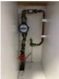
Vannmåler og stoppekran i skapinnredningen på vaskerommet.
