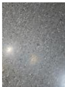
Merker og enkelte mindre skader på gulvbelegg
