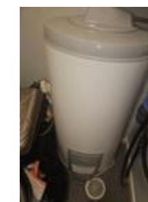
Varmtvannstank ca 200 liter i boden.
