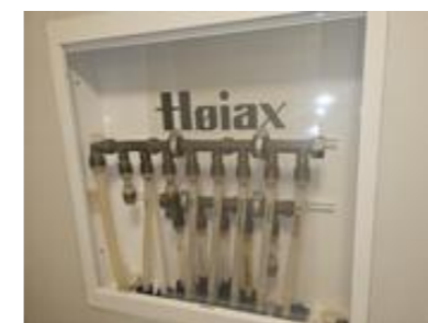
Fordelingsskap for tappevann
