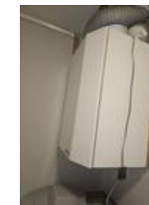
Balansert ventilasjon med varmegjenvinner
