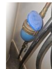
Stoppekran og måler for vann
