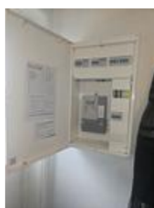
Sikringskap med automatsikringer og kursfortegnelse
