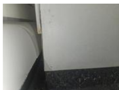
Skade og utetthet i vegg, nært dusjen
