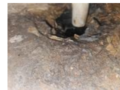
Plastsluk i gulvet. Vanskelig tilgjengelig for rengjøring og inspeksjon.
