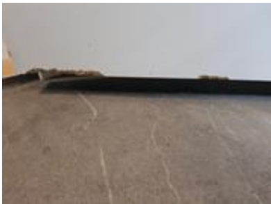
Skader på dørblad
