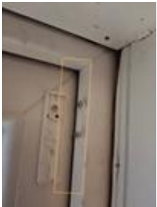
Luftlekkasje på pvc ytterdør. Det er også påvist fuktskader på utforing og glipper mellom utforing og karm.
