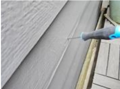
Råteskader på rekkverk.
