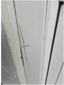
Sprekke i trevirke på balkongdør
