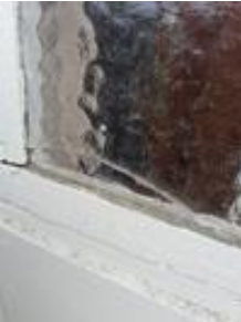
Sprekke i glasset på biinngangsdør
