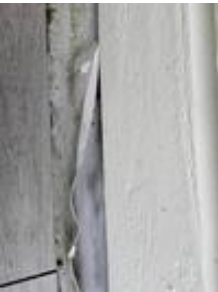
Det er observert 2 lag med PVC duk på altan. Det er ikke mulig å kontrollere tilstand på tettsjiktet da det ligger skjult.
