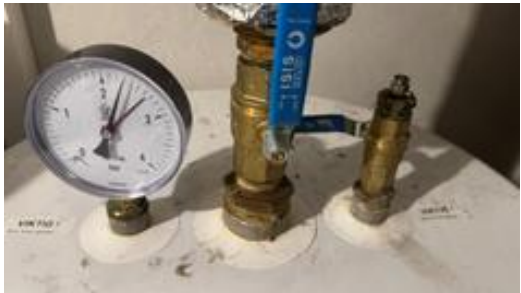
Bereder med oppvarming av vann som sentralvarmeanlegg.
