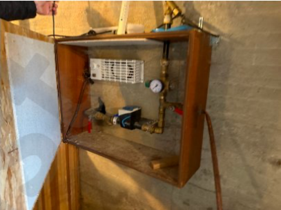
Vannfordeling / stoppekran i kjeller.
