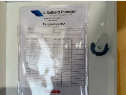
Kursfortegnelse i sikringsskapet.
