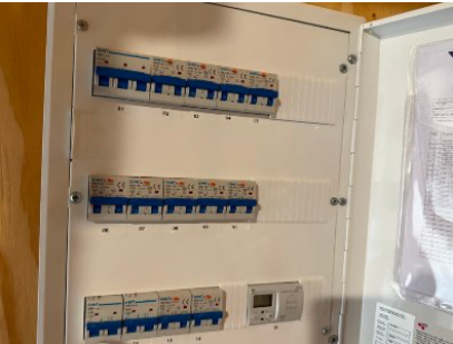
Sikringsskap med automatsikringer.
