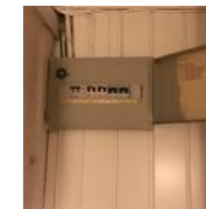
Sikringspanel i sokkelleilighet.
