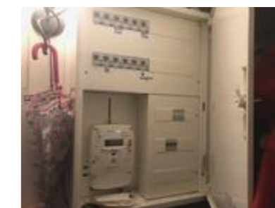
Sikringskapp er plassert i gang 1. etasje.
