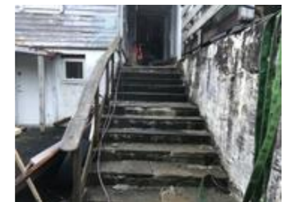
Det er forvitring og skader i betongtrapp.
