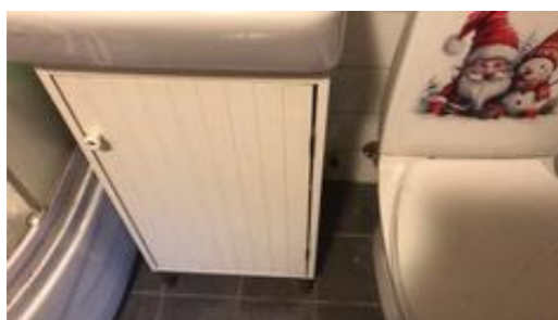
Vannrør har froset i yttervegg på bad i 1. etasje.
