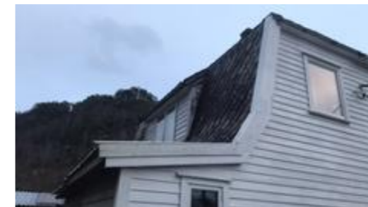
Det mangler takrenne og nedløp på tilbygg.
