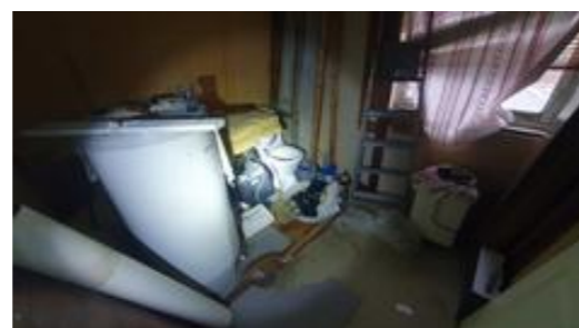
Varmtvannsbereider er defekt og må skiftes.
