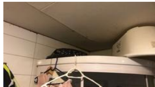
Fuktskade i himlingsplater, deler av himlingsplatene er seget ned.
