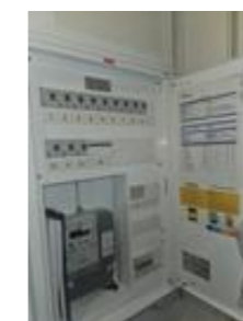
Sikringskap med automatsikringer og kursfortegnelse
