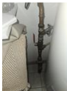
Stoppekran og reduksjonsventil for vann
