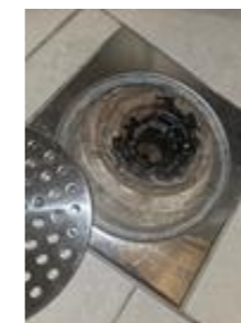
Plastluk med mansjett og klemring i boden
