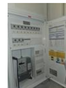
Sikringskap med automatsikringer og kursfortegnelse
