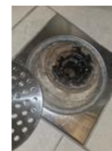
Plastluk med mansjett og klemring i boden
