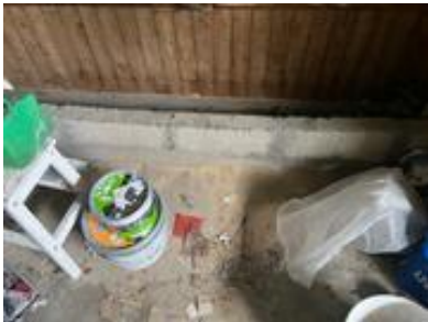
Det er murt opp en kant mot garasjeporten, dette må tettes bedre.
