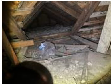
Viser loft, ikke etterisolert.
