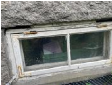
Viser kjellervindu med åpninger i pussen rundt.
