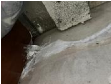
Viser fukt/saltutslag innvendig i kjeller.
