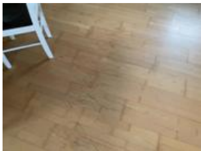
Bruksslitasjer/merker i parkett.
