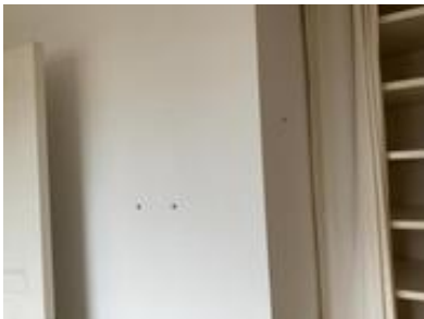
Merker/plugger og bruksslitasjer på enkelte vegger.
