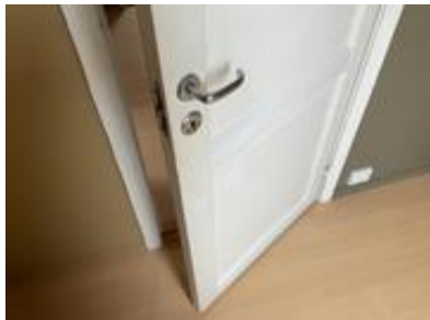
Bruksslitasje/merker på innerdører.
