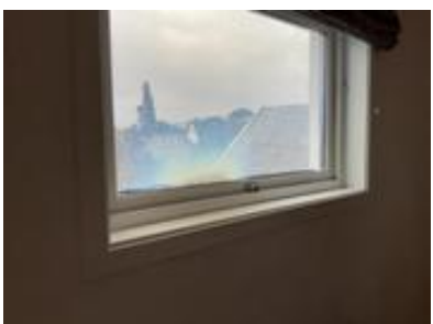
Misfarging i glass.
