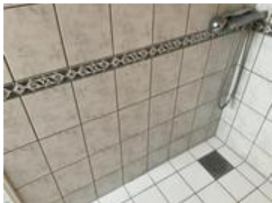
Borrede hull i fliser.
