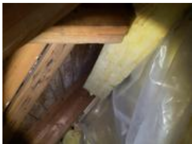
Isolasjon i skråtakskonstruksjon, ingen lufting.
