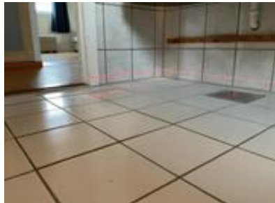
Ingen fall fra dør, ingen oppdrett på terskel.
