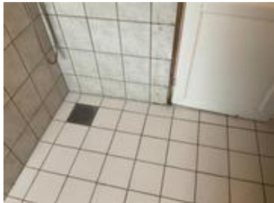
Dør plassert i dusjens fuktzone.
