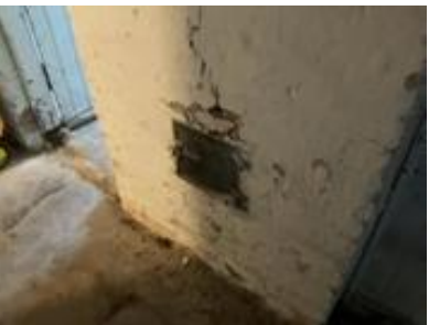
Riss og sprikker i pipe, her i kjeller.
