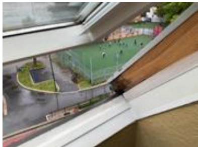
Overlysvinduer har værslitasjer i nedre kant ramme, begynnende råteskader.
