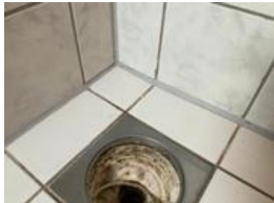
Bom/hullyd under enkelte fliser på gulv.
