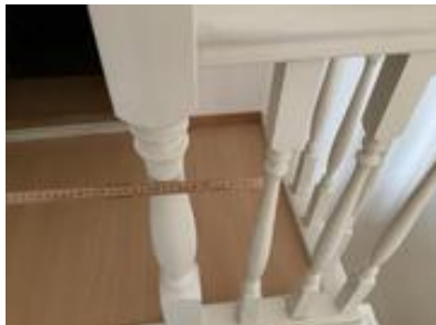
Større åpninger mellom spiler.
