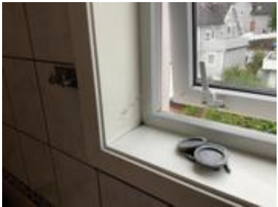
Fuktskader i foring på bad.
