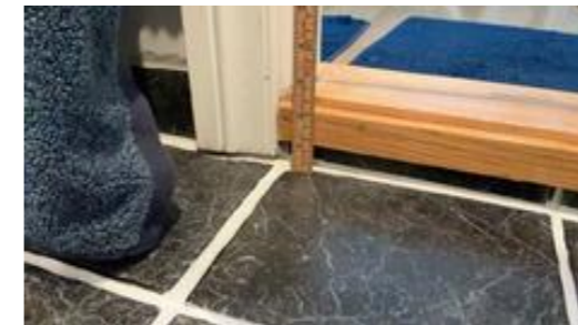
Høy terskel ved dør.
