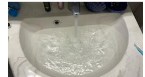
Det er dårlig avrenning fra servant.
