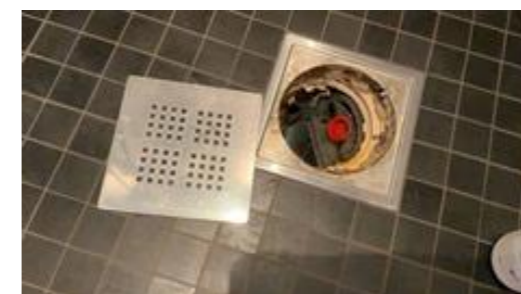
Plastsluk fra byggeår.
