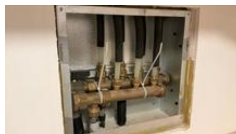
Rør i rør skap
