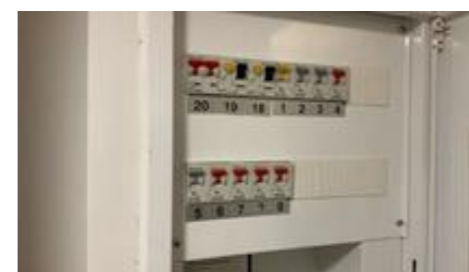
Sikringskap med automatsikringer.
