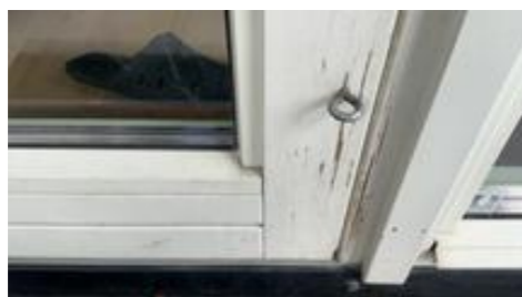
Slitasje i overflate på balkongdør.
