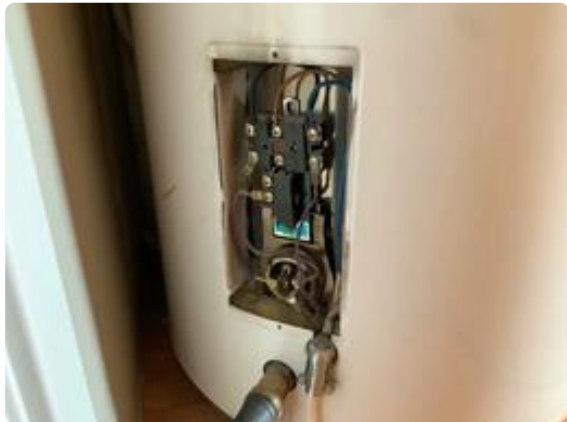
Åpent ledningsnett bak løst deksel
