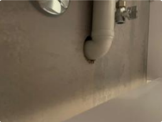
Åpent rund rørgjennomføring
