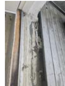
Lite fagmessig tetting i underkant av døren mot vaskerommet, begynnende fuktskade på terskelen
