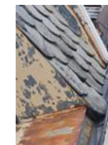
Løs takstein på mansarden mot sør
