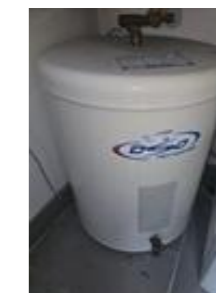
Varmtvannstank på vaskerommet
