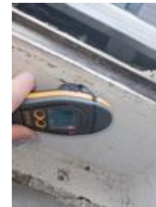
Høyt fuktinnhold i veggen under døren mot vaskerommet
