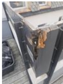
Begynnende råteskade på del av rekkverket
