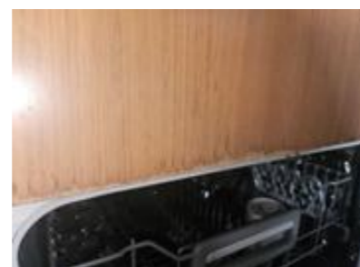
Fuktmerker på skapfront
