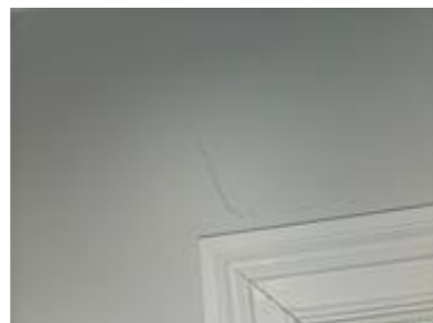
Sprekk i malt vegg
