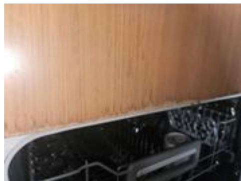
Fuktmerker på skapfront
