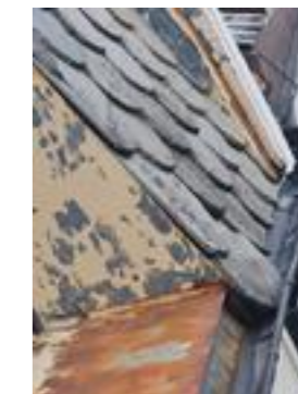
Løs takstein på mansarden mot sør
