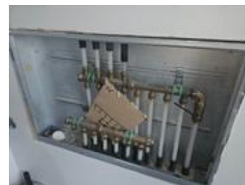
Fordelingsskap for tappevann
