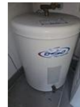
Varmtvannstank på vaskerommet
