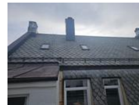
Rusten tekkning over vaskerommet
