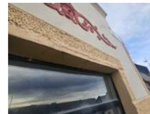
Begynnende rustsprenging over vindu. Riss / sprekker i fasaden.
