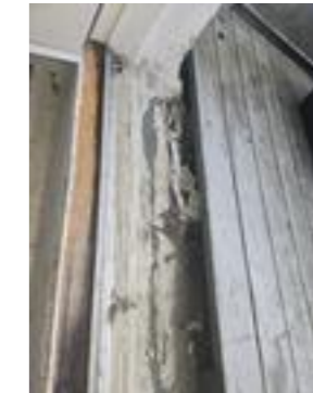
Lite fagmessig tetting i underkant av døren mot vaskerommet, begynnende fuktskade på terskelen
