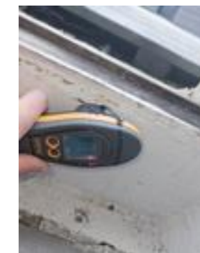
Høyt fuktinnhold i veggen under døren mot vaskerommet
