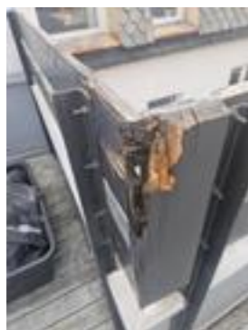
Begynnende råteskade på del av rekkverket
