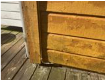
Avflassing og misfarget kledning.
