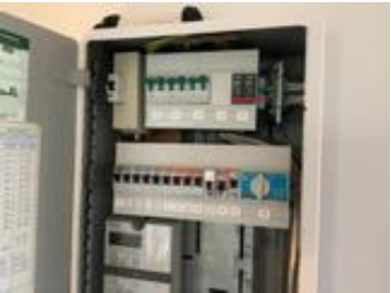
Sikringsskap med automatsikringer.
