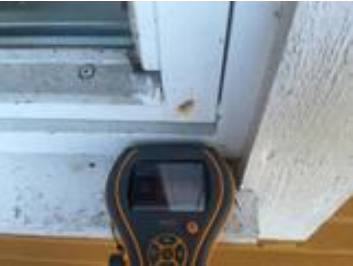
Forhøyet fuktnivå i vindu.
