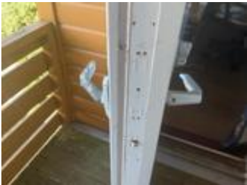
Løst/defekt dørvrider på balkongdør.
