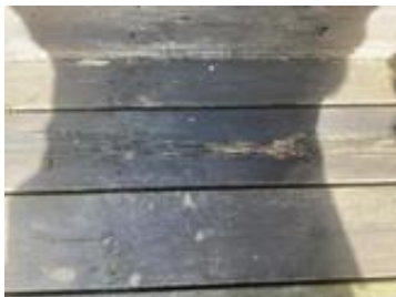
Skadet terrassebord i trappetrinn.
