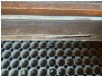
Sprekk i terskel på hoveddør.
