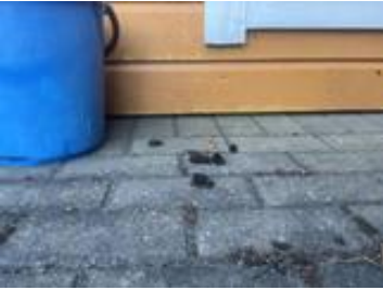
Liten avstand til bordkledning.
