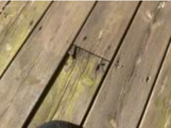
Slitasje på terrassebord.
