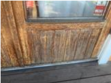
Overflateslitasje på terrassedør.
