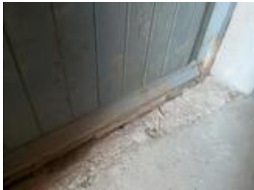
Manglende avslutning på kjellerdør.
